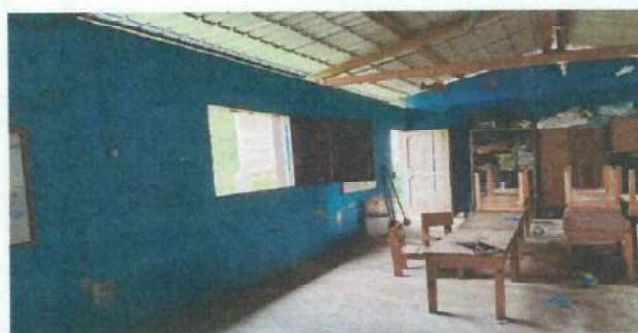
Foto 4: PISO DEL CENTRO EDUCATIVO CON NECESIDADES DE REMOZAR.
