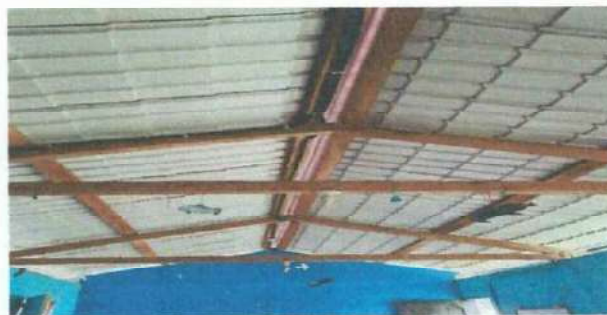
Foto 2: VISTA DE LA PARTE DEL TECHO CENTRO EDUCATIVO PARA REMOZAR ENTECHADO Y CUBIERTAS DE LAMINAS LAS CUALES SON DE MADERA..
