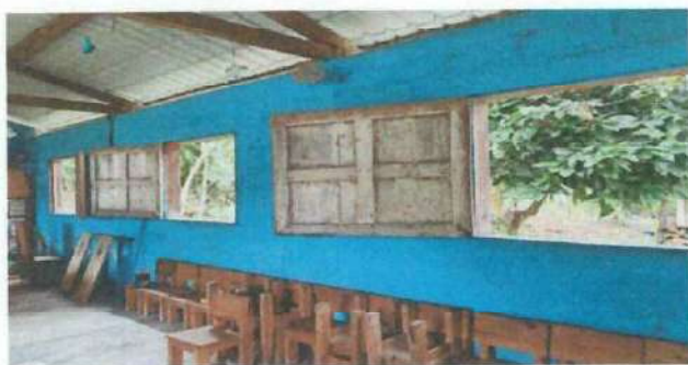
Foto 3: VISTA DE DE VENTANALES DE MADERA YA DETERIORADO CENTRO EDUCATIVO.
